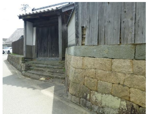
裏木戸付近の石垣に残る水位線
